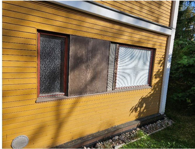
Kuva 14. Julkisivussa on pellityksiä ulkoseinän betonirakenteisten ulokkeiden päällä, (kuvan alaosa) sekä ikkunapellityksenä. Kuva maastokäynniltä 11.9.2025 Immo Kuha / Ramboll.
