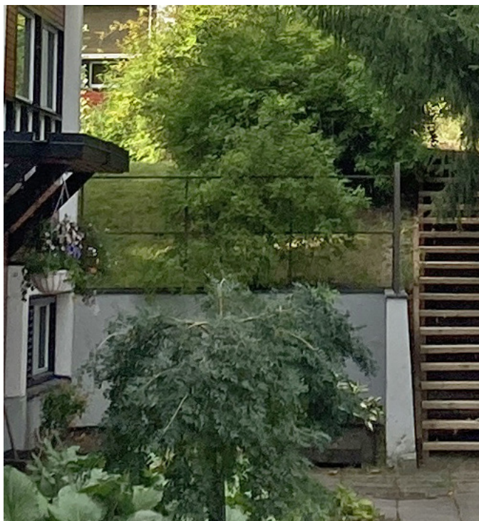
Paikalla valetut tukimuurit sopivat alueen pelkistettyyn ilmeeseen. Paikalla valetulla muurilla voidaan tukea suuriakin maamassoja.
